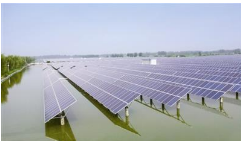
图为通威“渔光一体”电站项目
