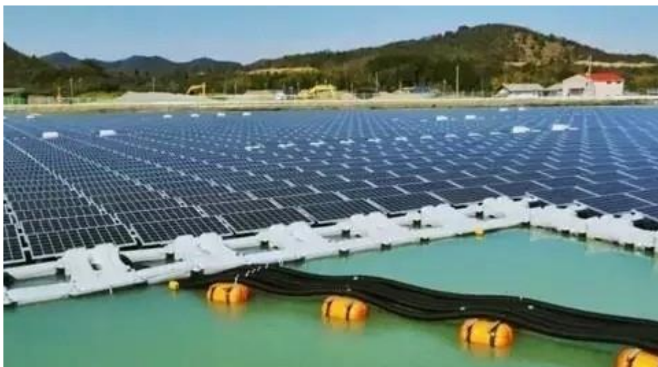
图为：日本最大水上光伏电站——兵库县加西市逆池水上兆瓦级光伏电站。
