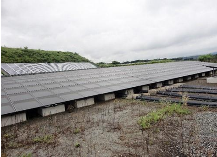
图 1：甲府市下向山町的“米仓山光伏电站”
