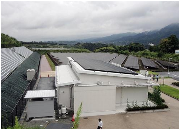
图 2：在屋顶上设置 20kW 太阳能电池板的“梦太阳能馆山梨”
