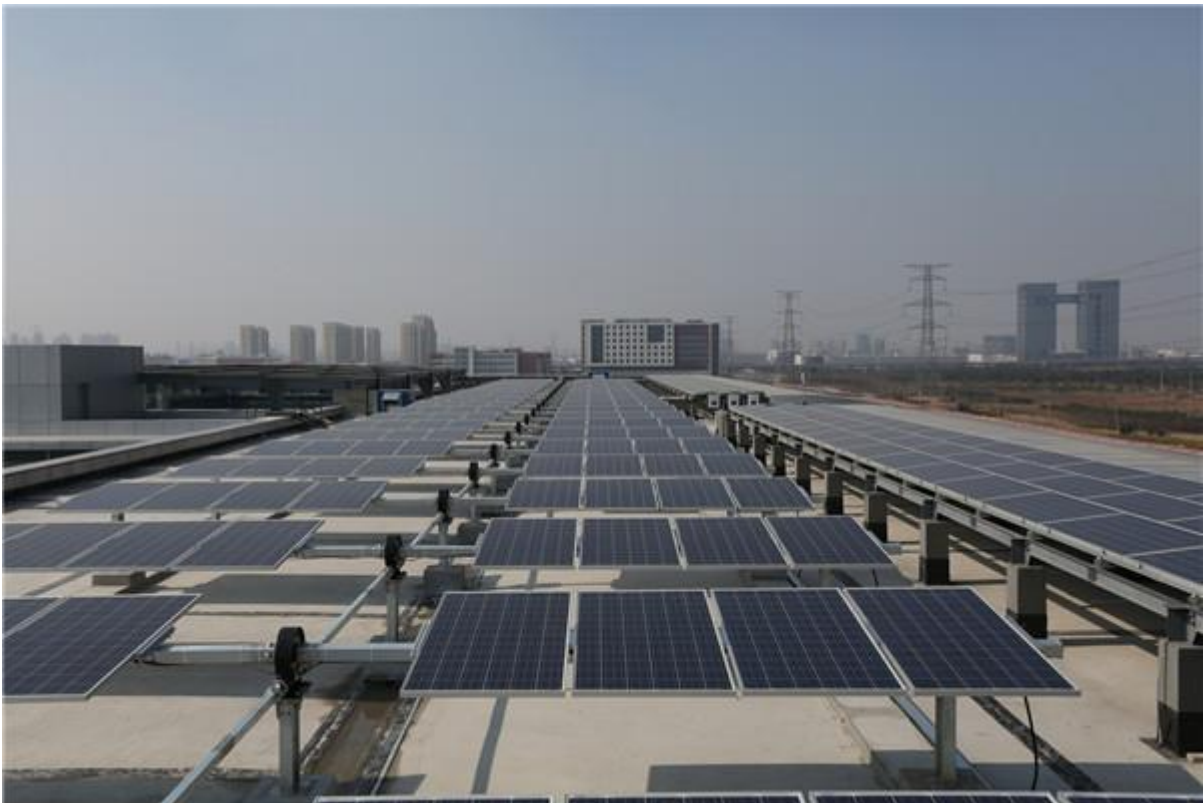
工研院屋顶 350K 光伏供电
