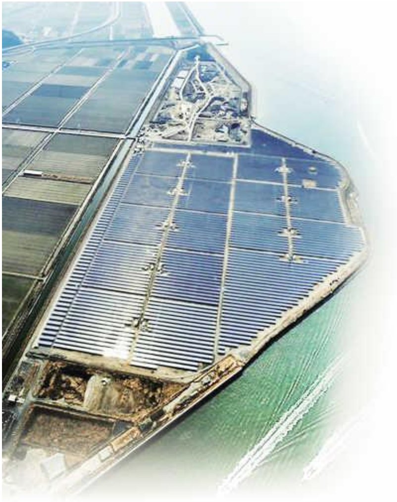
日本福冈市正在建造中的太阳能发电厂 北海道成市场中心
