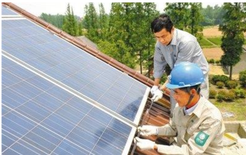
朱启杰家屋顶改造的分布式光伏屋顶发电
