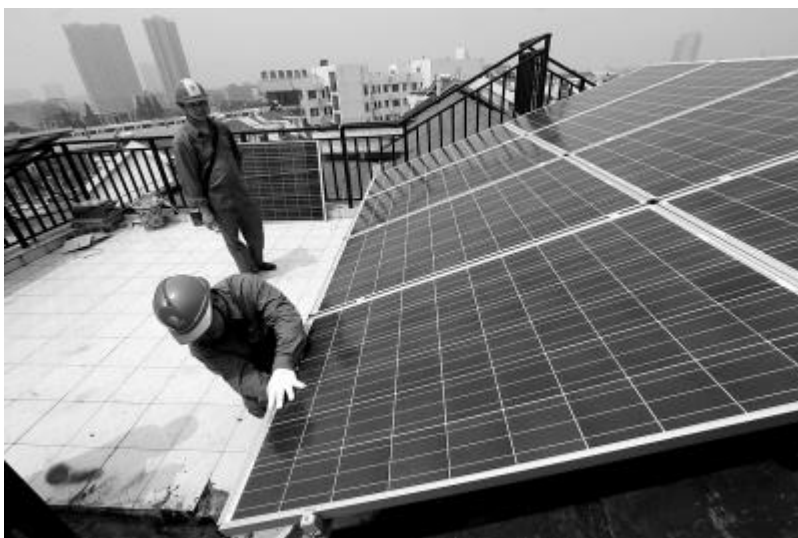
技术人员在高松家的楼顶平台上验收太阳能发电站设施
