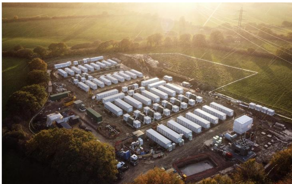
壳牌公司在英国威尔特郡部署的 100MW 电池储能项目
