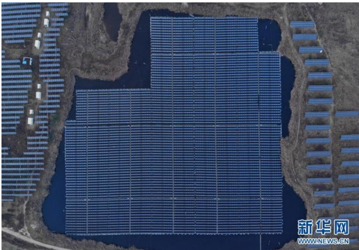
无人机拍摄的临西县灵溪湖水光伏电场 新华社记者 杨世尧 摄
