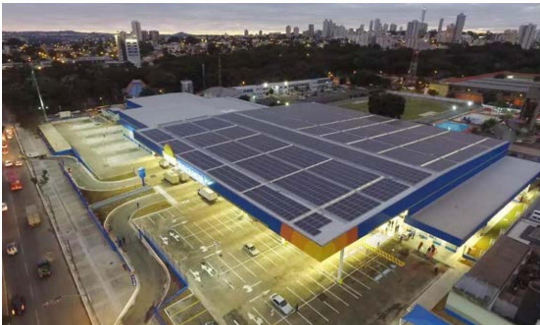
5MW 巴西 Greenyellow 屋顶分布式电站（项目局部图）
