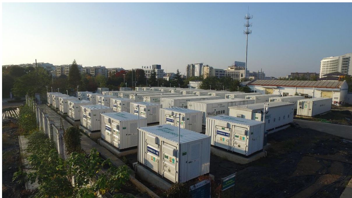
江苏省首个电网侧储能示范项目（丹阳电站）
