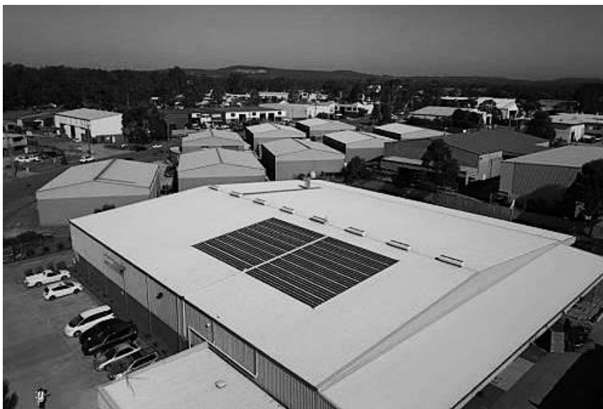
200平方米的薄膜太阳能电池安装在澳公司厂房屋顶。
