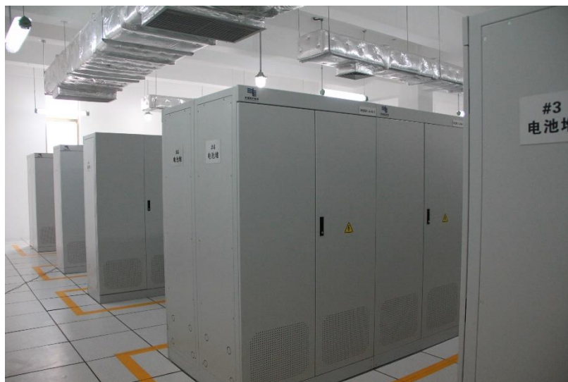
图为储能站 1 号电池室
