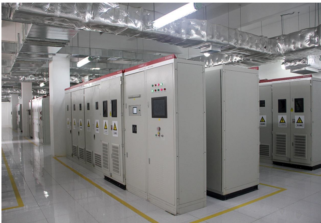
图为 863 项目 2 兆瓦 10 千伏级联储能系统
